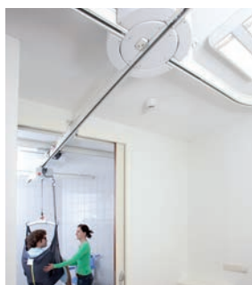
Monorail, rotonde en traverse-systeem.
