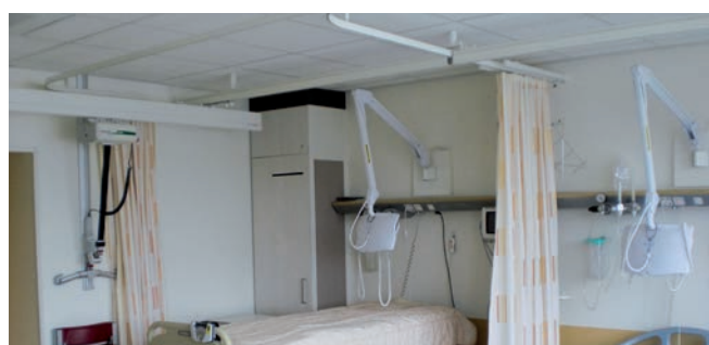
Ziekenhuiskamer meerbeds met traverse-systeem voorzien van gordijndoorvoer.
